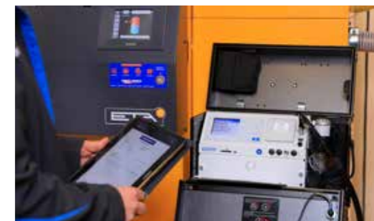
Mit dem Tablet lassen sich Heizmesswerte ablesen und dokumentieren.
