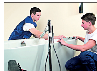
txn. Empfehlenswert vor der Ausbildung: Im Rahmen eines Schülerpraktikums kann zum Beispiel der Beruf des Anlagenmechanikers kennengelernt werden. Außerdem lässt sich dadurch prüfen, ob der Arbeitsalltag den eigenen Erwartungen entspricht. Foto: ZVSHK/txn
