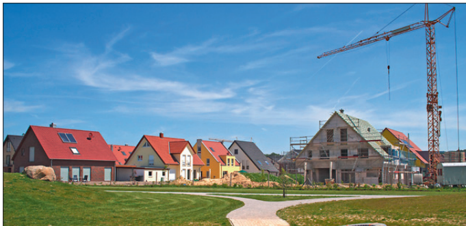
txn. Vor dem Kauf eines Baugrundstücks sollte geprüft werden, welche Versorgungsleitungen vorhanden sind und ob beispielsweise Verbrennungsverbote die Entscheidungsfreiheit bei der Wahl des Heizsystems einschränken. Foto: Kaarsten/Fotolia
