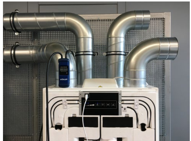
Abbildung 75: Differenzdruckmessung im Rahmen der Instandhaltung und Inbetriebnahme eines zentralen Lüftungsgerätes, Einsatzgebiet Lüftungs- und Klimatechnik (Quelle: BZD)
