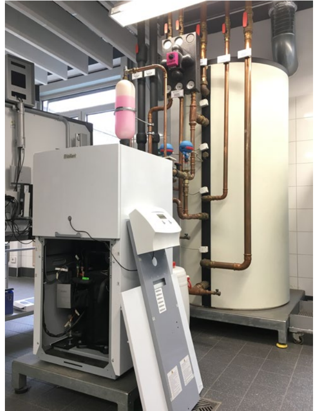
Abbildung 78: Systemuntersuchung im Rahmen der Instandhaltung und Inbetriebnahme einer Wärmepumpe, Einsatzgebiet erneuerbare Energien und Umwelttechnik (Quelle: BZD)
