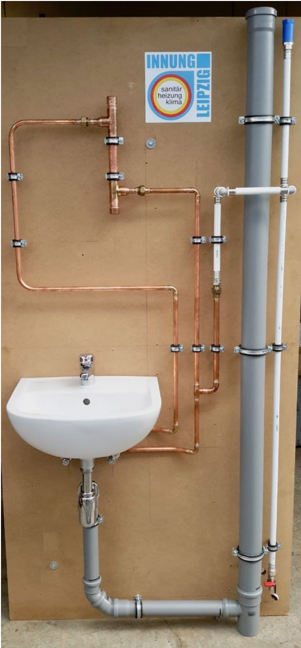
Abbildung 56: Ansicht 1 zum Arbeitsergebnis der praktischen Aufgabe im Prüfungsbereich Versorgungstechnik (Quelle: Innung Leipzig)
