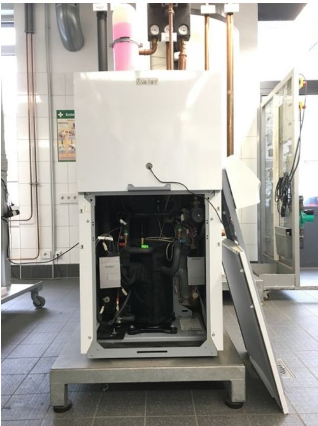
Abbildung 77: Instandhaltung und Inbetriebnahme einer Wärmepumpe, Einsatzgebiet erneuerbare Energien und Umwelttechnik (Quelle: BZD)
