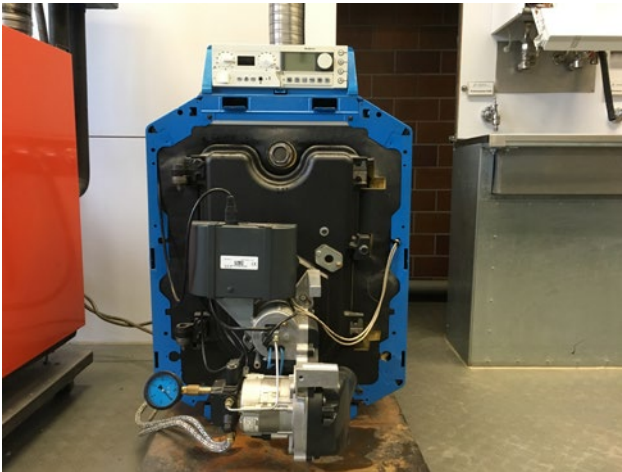
Abbildung 73: Instandhaltung und Inbetriebnahme eines Wärmegerätes, Einsatzgebiet Heizungstechnik (Quelle: BZD)
