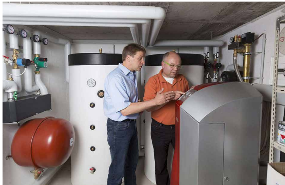
Eine regelmäßige Wartung erhöht die Lebensdauer und Effektivität der Heizung.
